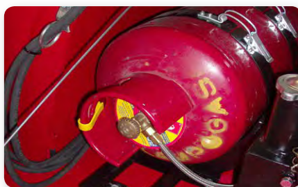
Impianto GPL LPG system Instalación de GLP
