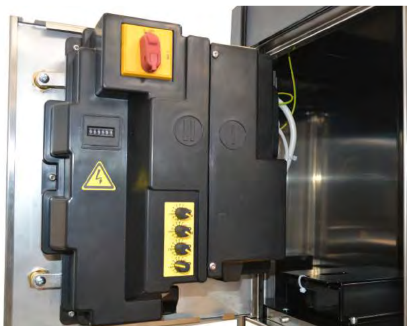
QUADRO ELETTRICO E GETTONIERA INTEGRATI E DI FACILE ACCESSO EASY ACCESS INTEGRATED CONTROL BOARD
